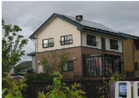
写真1. 宮岡聖次宅の3KW系統連係太陽光発電設備
