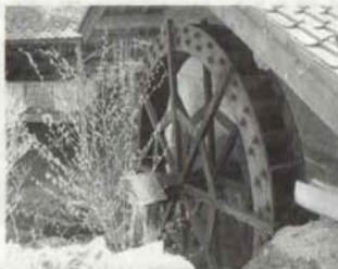
小水力発電（水車利用） 野外照明、電気柵（500W）
