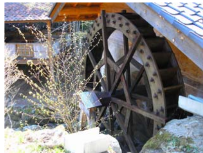
水力発電(屋外照明、電気柵 500w)
